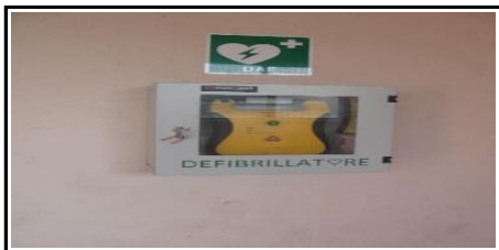
COLLOCATO ALL'INTERNO DELLA PALESTRA AL DI SOTTO DEGLI SPALTI
